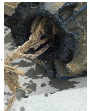
Photos of pump at sewer treatment plant · Fotos de bomba en planta de tratamiento de alcantarillado
